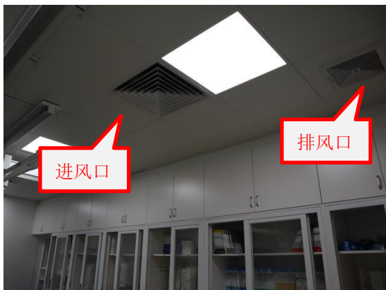
图 3-16 机房内进、排风口
