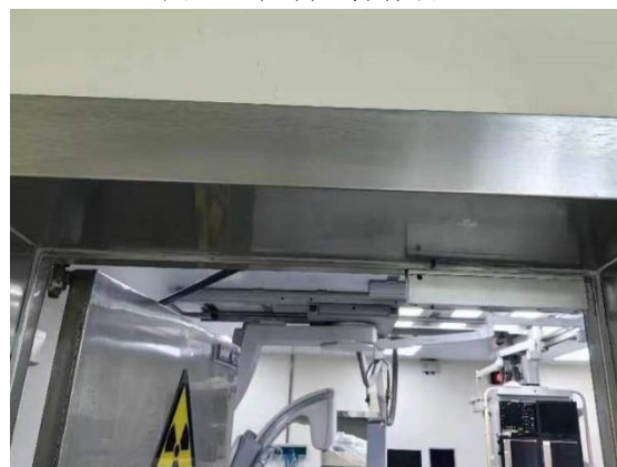
图 3-7 控制室机房防护门自动闭门装置
