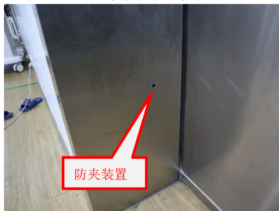
图 3-9 机房西侧防护门自动闭门装置
