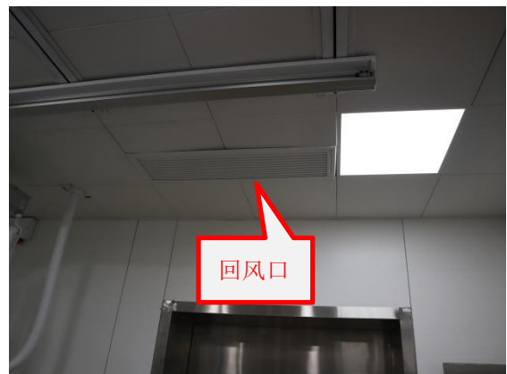
图 3-17 机房内回风口
