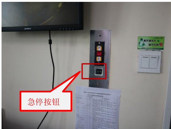
图 3-14 控制室急停按钮
