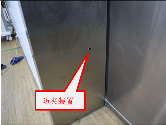
图 3-10 患者通道出入机房防护门防夹装置
